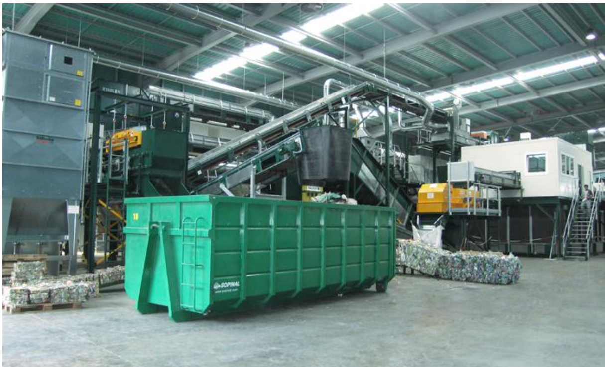
Linha de triagem de embalagens plásticas e metálicas
