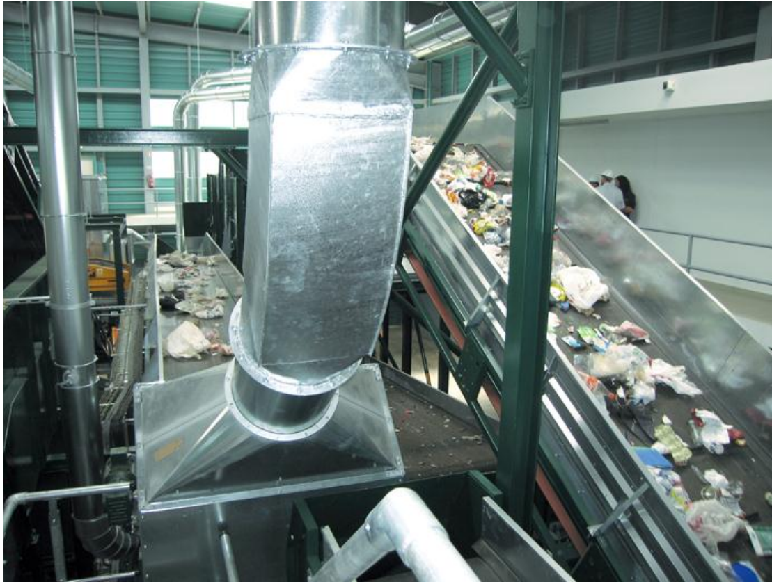
Sistema de aspiração de materiais leves
